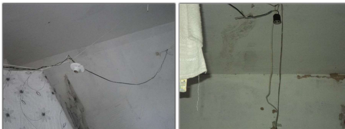
Figura 47: Celas com fiação exposta e infiltrações. Fonte: MNPCT.
