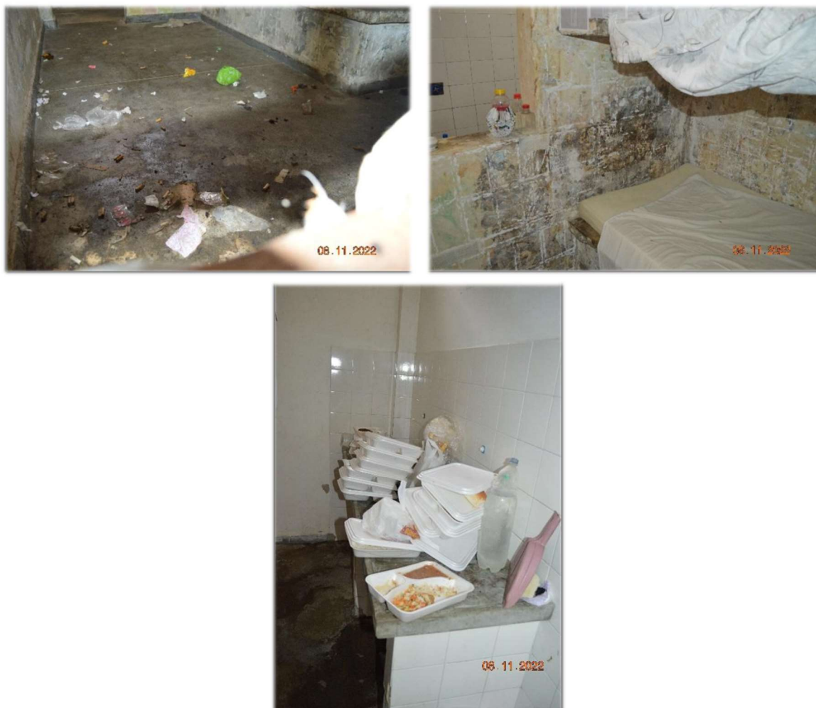
Figura 33: Celas insalubres e com lixo acumulado. Fonte: MNPCT.
