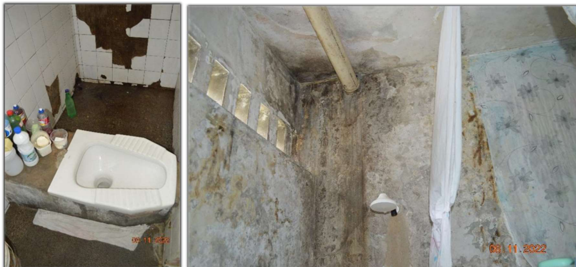
Figura 34: Banheiro das celas do seguro. Fonte: MNPCT.
