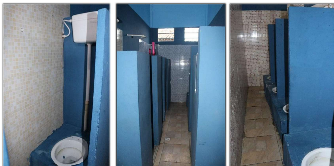
Figura 24: Banheiro de uso coletivo sem privacidade. Fonte: MNPCT.
