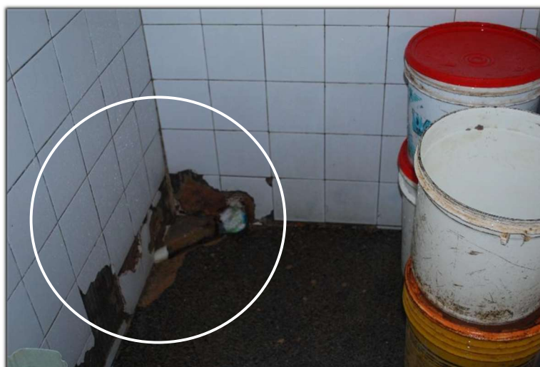
Figura 36: Local indicado em banheiro de cela no qual saem ratos e baratas. Fonte: MNPCT.
