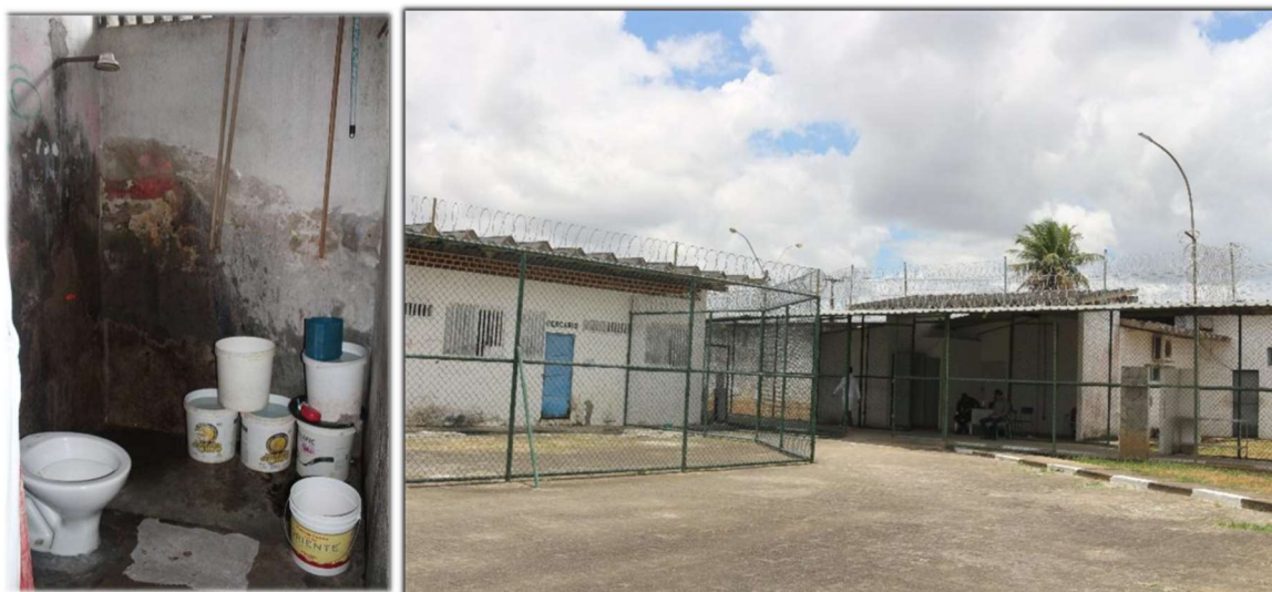
Figura 64: Estrutura do banheiro da cela e solário em área de passagem.
