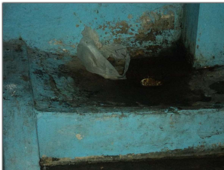
Figura 90: Cella do isolamento com um buraco no piso para uso sanitário. Fonte: MNPCT.
