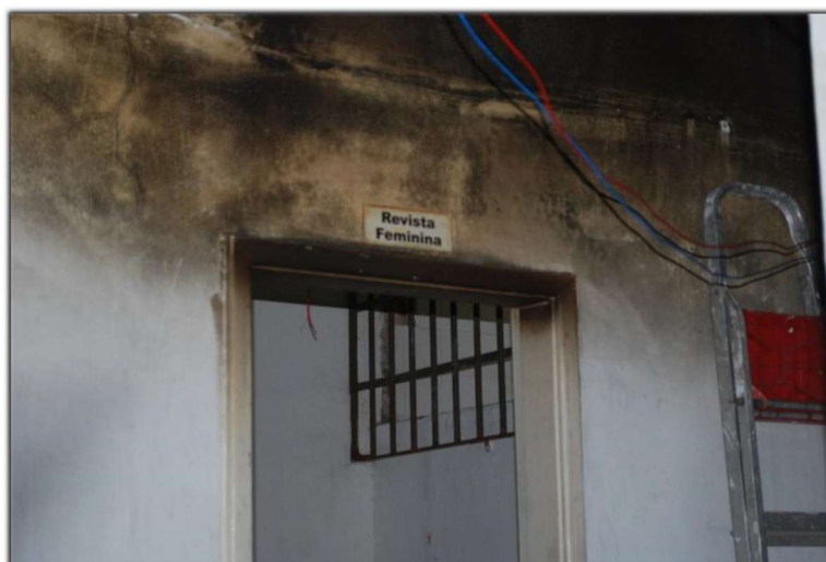
Figura 32: Área da unidade que sofreu incêndio. Fonte: MNPCT.
