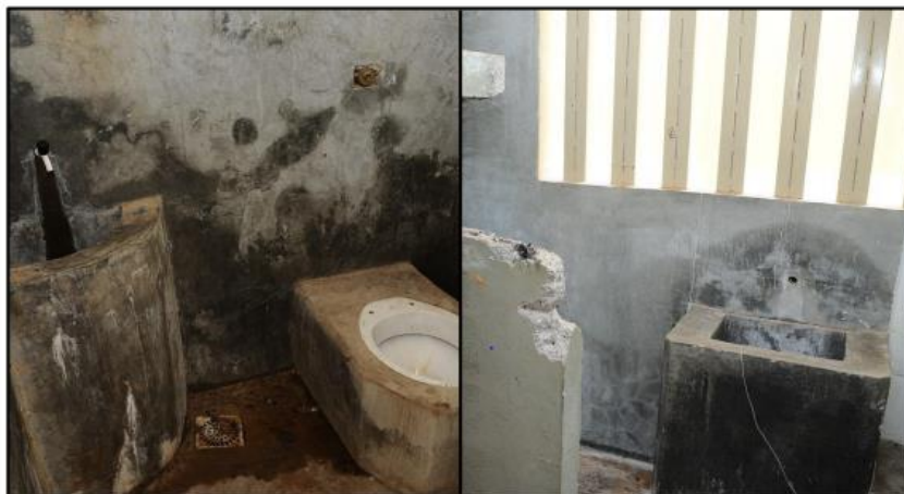
Imagem 29: Fotografias da estrutura predial deteriorada na unidade. Fonte: Acervo DPE-GO, 2020.
